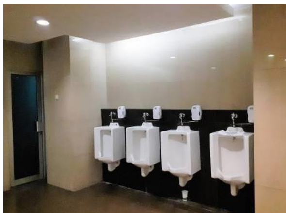
Gambar15. Urinoir area pada Solo Hartono Mall yang dilengkapi dengan fasilitas pendukung berupa 4 unit urinoir. (Foto: Agung P, 2020)
