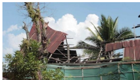
Gambar 8. Anjuang rumah gadang yang rusak, Solok (Sumber: Cuplikan layar film Perkampungan Adat Sijunjung , 2016,
