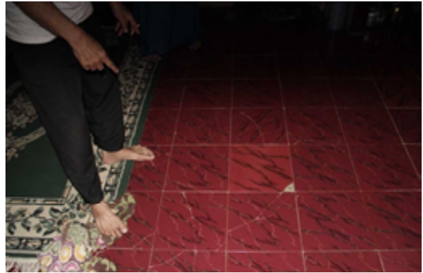
Gambar 3. Kebanyakan lantai yang menggunakan keramik retak dan pecah. (Foto: Anggar Erdhina A, 2016)
